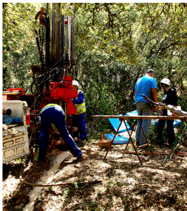
Una de las perforaciones del Camino de la Roza sobre cavidad detectada en la geofísica. FOTO: Miguel Ángel Martín
